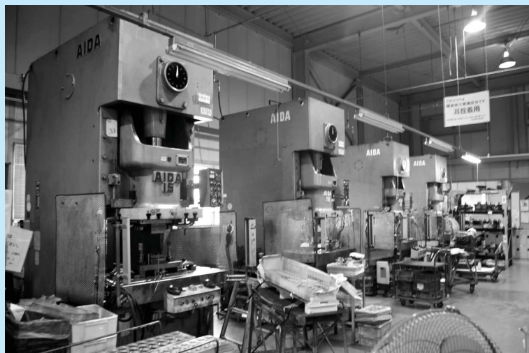
▲ NC1-80トン、110トン、150トン4台加工ライン
